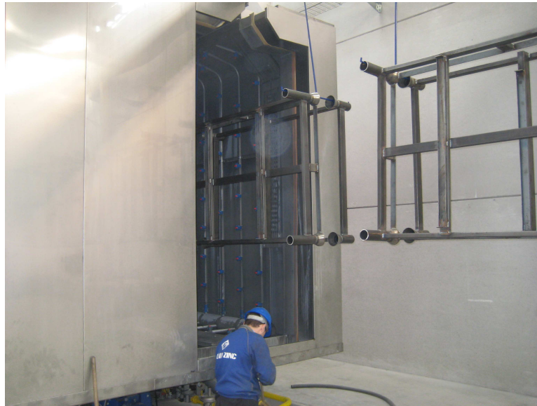
Figura 5. Túnel de tratamiento químico
